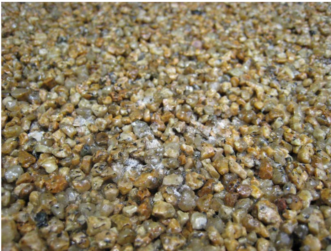
Bild 2: Detail der Körnung 2/4mm in der Rollspur mit Ausbrüchen.
