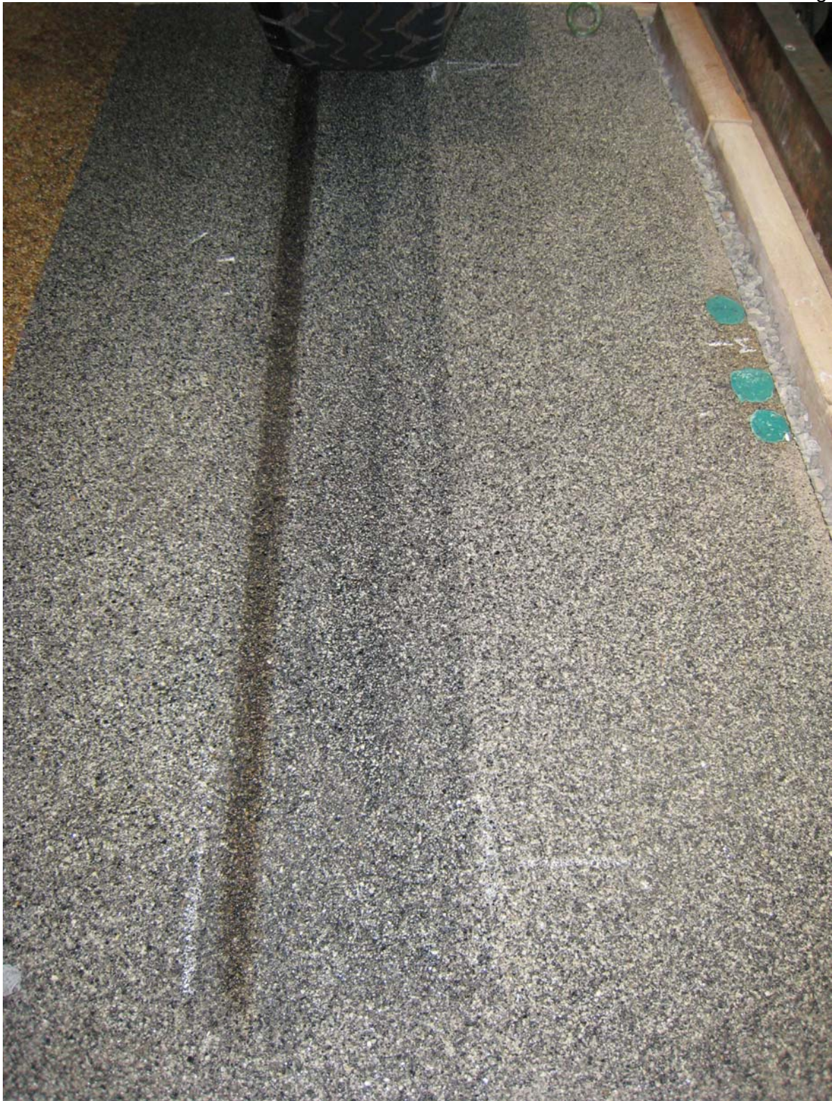
Bild 5: Zustand der Deckschicht 1/3mm nach Abschluss der Phase 6. Der dunkle Streifen ist die Folge eines Lecks im Bremssystem der Versuchseinrichtung. Die Bremsflüssigkeit DOT4 wurde vom Reifen in die Deckschicht eingearbeitet. Schäden in Form von Ausbrüchen waren zu diesem Zeitpunkt (nach 50.000 LW) nicht erkennbar.
