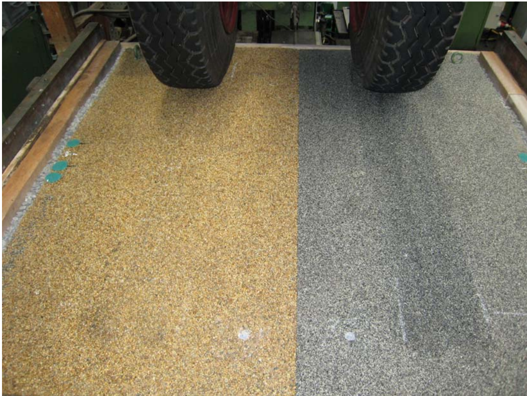
Bild 1: Zustand der Oberflächen nach Versuchsphase 5. Deckschicht mit Körnung 1/3mm (grau, im Bild rechts) ohne sichtbare Beschädigungen. Die Deckschicht mit Körnung 2/4mm (gelb, im Bild links) zeigt vereinzelte Kornausbrüche in der Rollspur.
