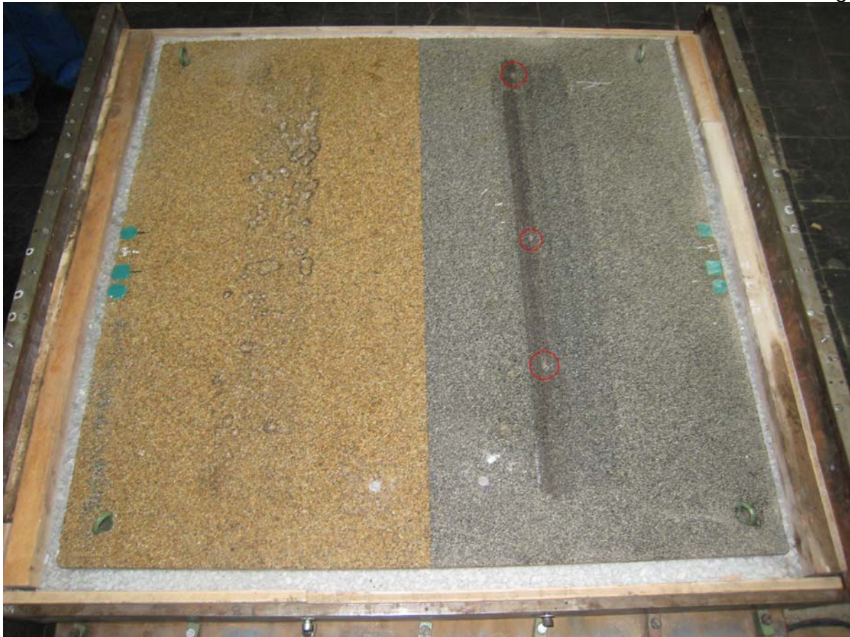
Bild 6: Zustand der Probekörperoberfläche nach Versuchsende (insgesamt 60.000 LW). Während in Phase 7 (mit Temperaturbelastung) an der Deckschicht 2/4mm (links, gelb) keine signifikante Zunahme der Ausbrüche zu verzeichnen war, zeigten sich an der Deckschicht 1/3mm (rechts, grau) drei Ausbrüche in dem mit Bremsflüssigkeit getränkten Streifen. Diese räumliche Zuordnung dieser Schädigung spricht mit sehr großer Sicherheit dafür, dass der chemische Angriff in Verbindung mit Temperaturbelastung und Rollbelastung für den Ausbruch ursächlich ist.
